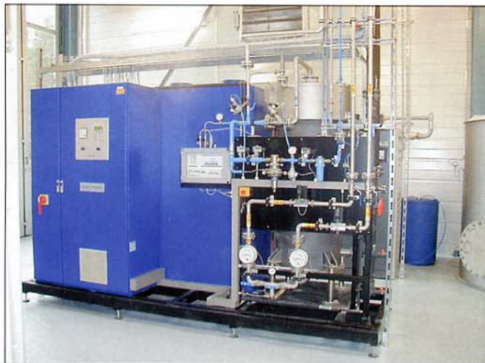
Bild 1: Ozon-Brauchwasser- aufbereitungsanlage von Wedeco
