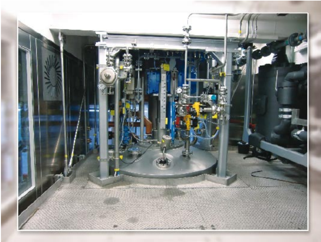
Abb. 2: Der Filternutschentrockner arbeitet in einem abgetrennten Raum, während die Abfüllung des Produkts in einem Reinraum der Klasse D erfolgt.
